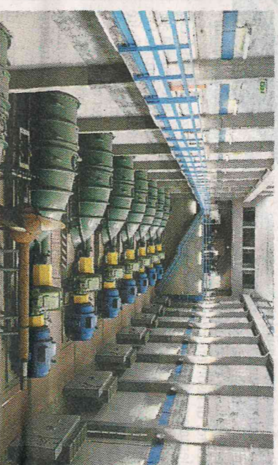
L'interno dell'impianto idrovoro di Valle Lepri
